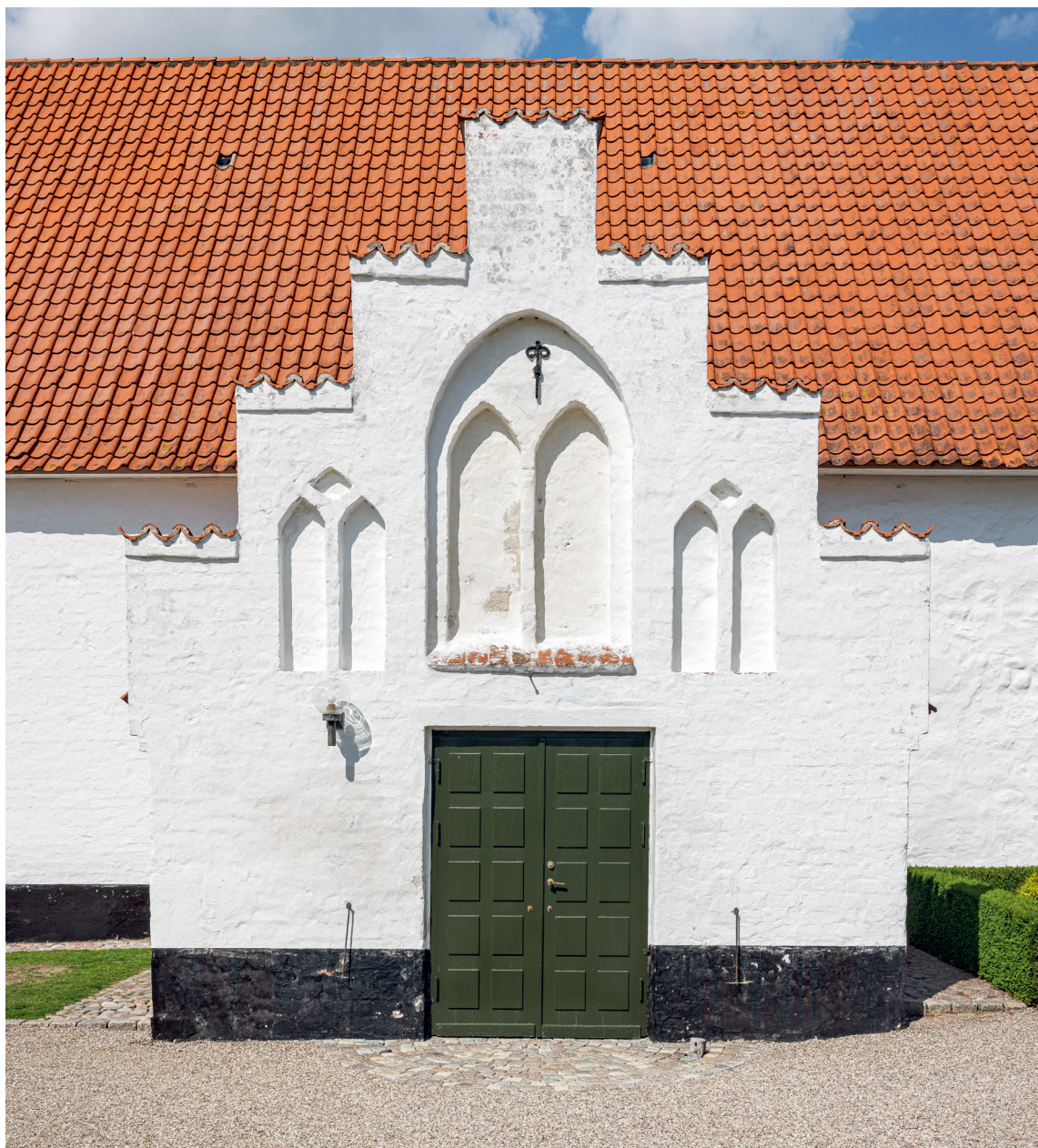
Fig. 19. Våbenhuset set fra syd (s. 3986). Foto Arnold Mikkelsen 2023. – The porch seen from the south.
