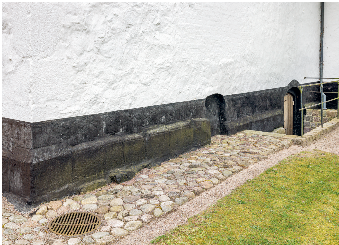
Fig. 13. Profilerede sokkelkvadre under koret og dets forlængelse set mod sydvest (s. 3981). Foto Arnold Mikkelsen 2023. – Profiled footing ashlar below the chancel and its extension looking south west.
