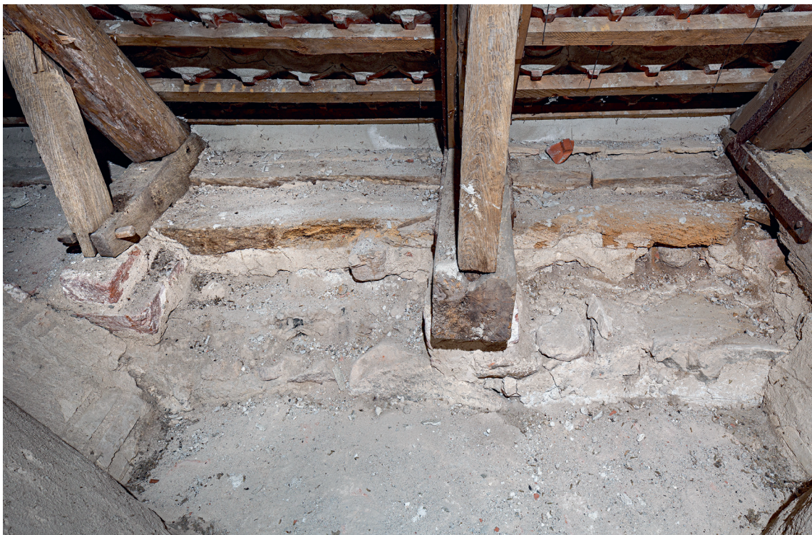
Fig. 56. Udsnit af langhusets søndre bagmur mellem de vestligste hvælv over loftet (s. 3271). Foto Arnold Mikkelsen 2020. – Detail of the southern back wall of the nave between the westernmost vaults above the ceiling.
