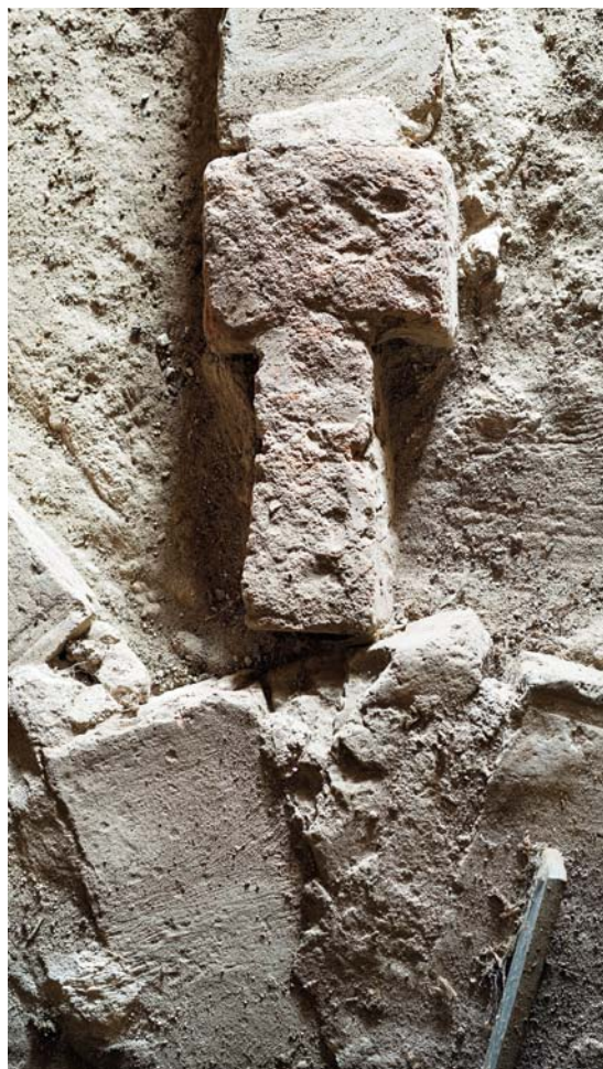
Fig. 19. Detalje af hvælvet i nordre korsarm. Ribbesten anvendt i overribben (s. 2013). Foto Arnold Mikkelsen 2014. – Detail von Gewölbe im nördlichen Kreuzarm. In Oberrippe verwendete Rippensteine.
