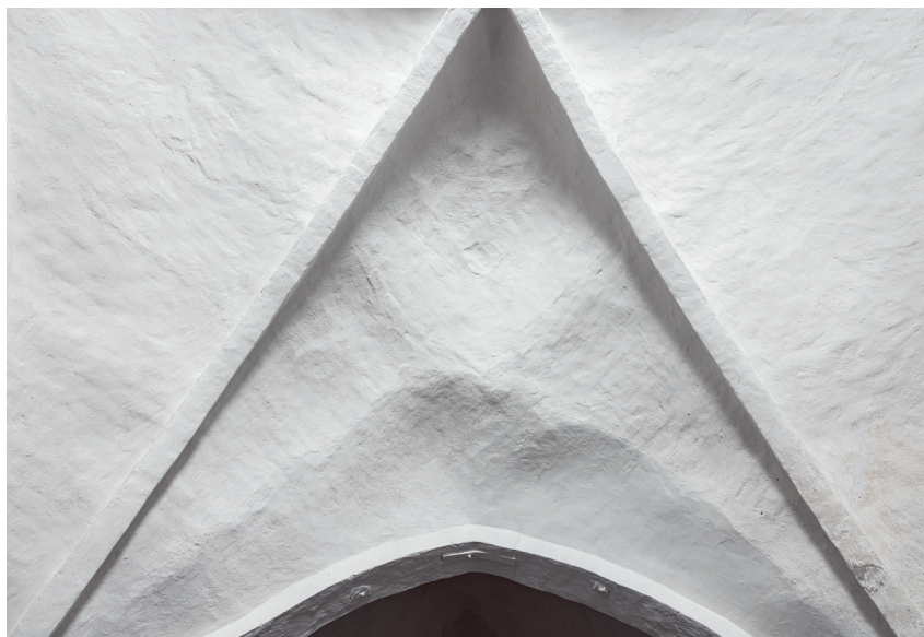
Fig. 113. Ommuring af korets østre hvælvkappe i forbindelse med korforlængelsens opførelse med hvælv (s. 6410). Foto Arnold Mikkelsen 2021. – Renovation of the chancel's eastern severy due to the construction of the chancel extension with vaulting.
