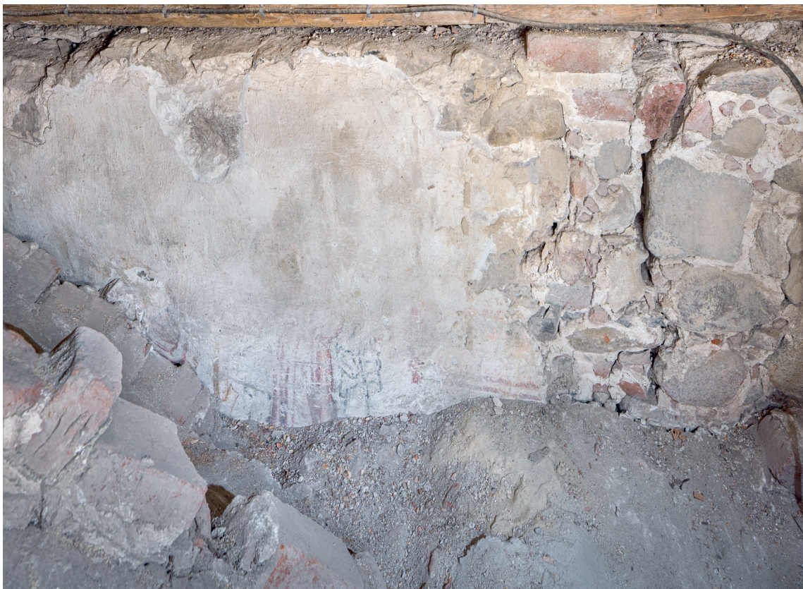
Fig. 115. Overmur i korets nordside med kalkmaleri (s. 6433) og revne i muren mellem koret og korforlængelsen (s. 6410). Foto Arnold Mikkelsen 2022. – Upper wall in the chancel's north side with wall paintings and a crack between the chancel and the chancel extension.
