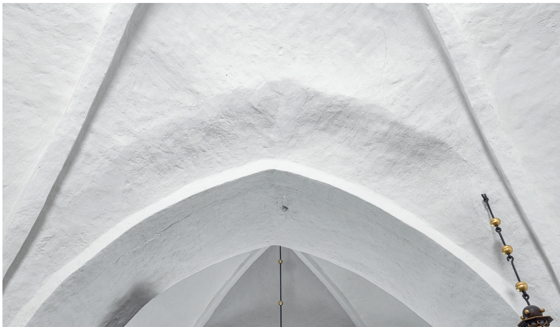
Fig. 22. Ommuring af korets vestre hvælvkappe i forbindelse med korbuens ændring (s. 6410). Foto Arnold Mikkelsen 2021. – Renovation of the chancel's western severy due to the change made to the chancel arch.
