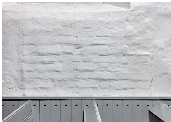
Fig. 9. Den tilmurede, romanske norddør, inderside (s. 6311). Foto Arnold Mikkelsen 2021. – The bricked-up, Romanesque north door, inside.
