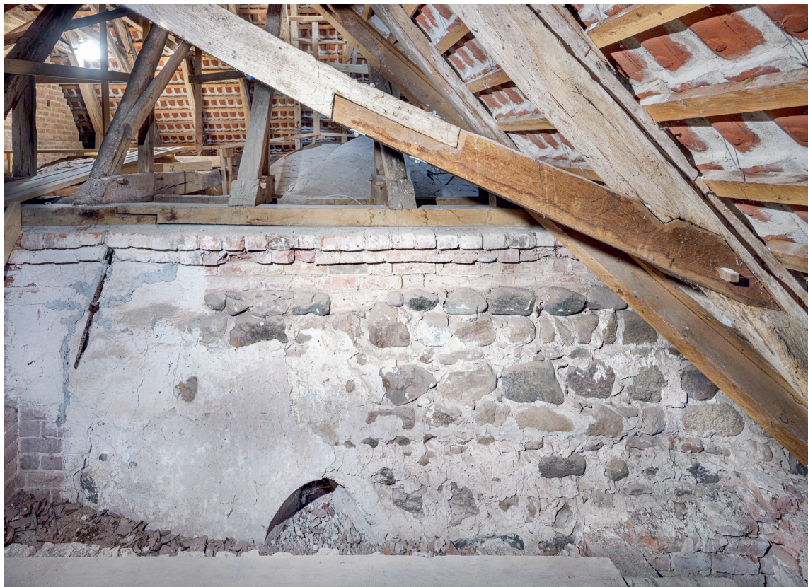
Fig. 8. Det romanske kors nordside med †vindue (s. 6311) og med murforhøjelse set fra nord (s. 6312). Foto Arnold Mikkelsen 2022. – North side of the Romanesque chancel with †window and with wall heightening seen from the north.
