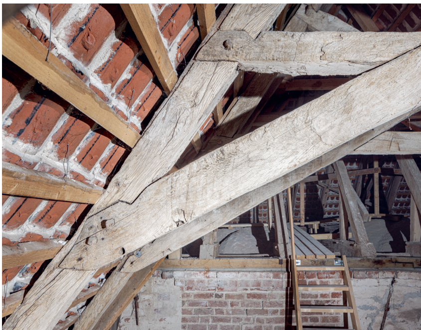
Fig. 54. Detalje af sakristiets tagværk med hagebladssamlinger, set mod syd (s. 6339). Foto Arnold Mikkelsen 2022. – Detail of sacristy roofing with oblique scarf joints, looking south.
