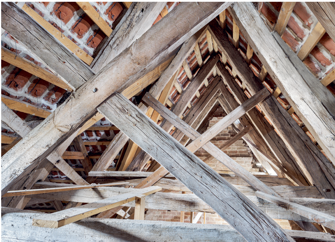
Fig. 49. Korets tagværk med stikspær i sydsiden (s. 6339), set mod øst. Foto Arnold Mikkelsen 2022. – Roofing of the chancel with side rafters on the south side, looking east.
