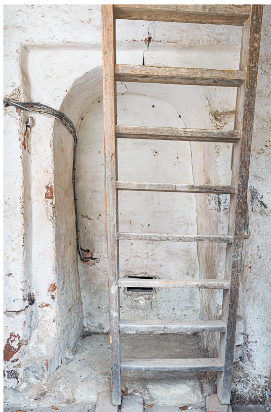
Fig. 20. Blændet dør i tårnets vestmur (s. 5708). Foto Arnold Mikkelsen 2019. – Bricked-up door in the west wall of the tower.
