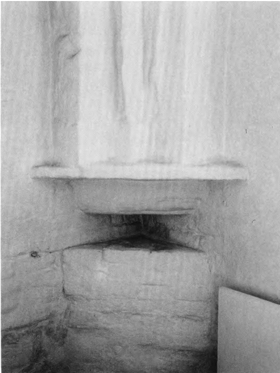
Fig. 11. Piscina i korets sydøstre hjørne (s. 2062). Peter Kristiansen fot. 1988. - Piscina in the south-east corner of the chancel.
