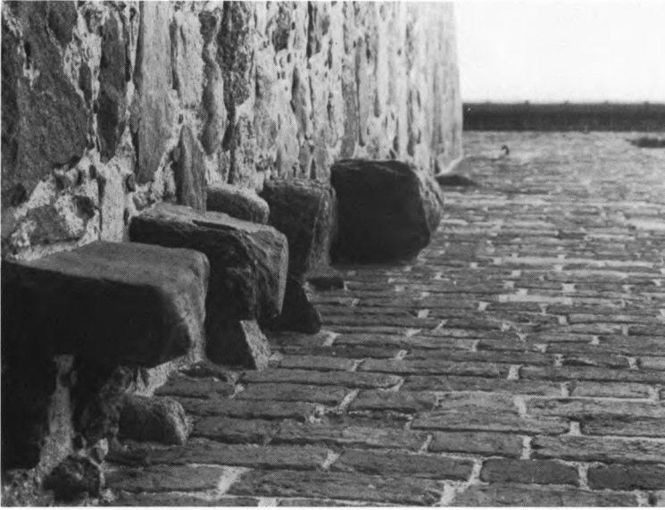
Fig. 4. Hjørnet mellem skibets vestgavl og tårnets nordfacade med fortanding til planlagt \dagger tårn (s. 1087). HS fot. 1983. - Corner between the nave's west gable and the tower's north facade with toothings for the proposed \dagger tower.
