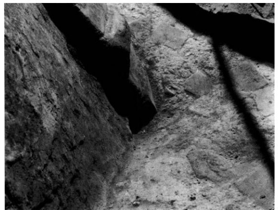
Fig. 12. Udsnit af hvælvets overside med overribbe samt skålformet udmuring og afløbshul i nordvestre hjørne af skibets østre fag (s. 3941). KdeFL fot. 1993. - The extrados of one of the vaults in the nave.
