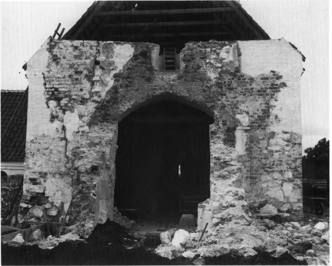
Fig. 13. †Triumfmuren set fra øst efter korets nedrivning. Foroven spor af det oprindelige †kors andet stokværk (s. 2519) og en rest af forbindelsen mellem korets og skibets loftsrum (s. 2522); ved nordre kormur et støttepillelignende fremspring samtidig med triumfmurens skalmuring (s. 2526). Kai Uldall fot. 1925. - †East wall of the nave from the east after the demolition of the chancel. Above, traces of the original †chancel's second storey, and relic of the connection between the loft over the chancel and nave; a pier-like projection contemporary with the facing of the east wall of the nave.
