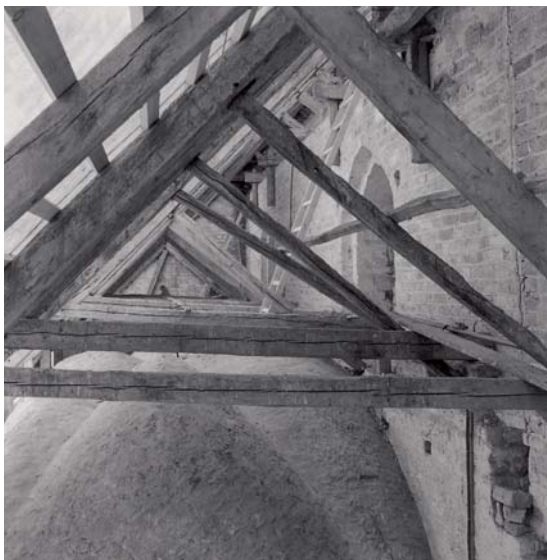
Fig. 30. Tagværk over nordre sideskib set mod øst (s. 1938-39). Foto HJ 1997. – View of the northern aisle's roof structure, towards the east.
